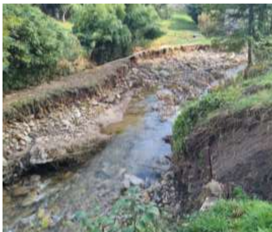
Erosion des berges et seuil dérasé amont du cinéma (FDPMA42) sur le Riotet.
